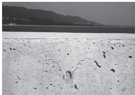
写真1 型枠面の生じる沈下ひび割れ 1)
